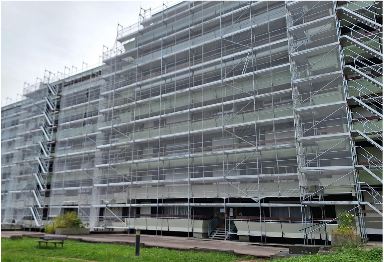
Les débuts du second ravalement du Clos de Médreville Les bâtiments « voilés » du côté de la rue Winston Churchill (janvier 2025) Vue du parc
